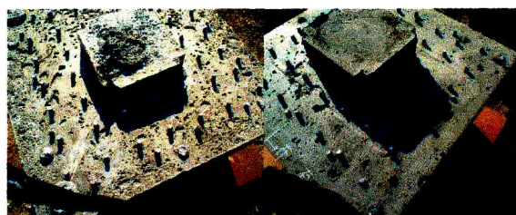
写真-1 コンクリートの表面状況
