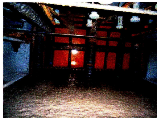
写真-3 接合部下フランジ下面の状況
